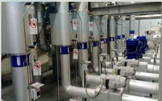
Her har vi installeret differenstrykmåling over 4 filtre. Vi har leveret instrumenterne til målingen samt tegnet og bygget instrumentstativerne. Derudover har vi stået for den mekaniske montage af impulsrør og stativer. En af udfordringerne med impulsrør er, at de ikke må stå med luft, der er derfor ligeledes installeret udluftning.
