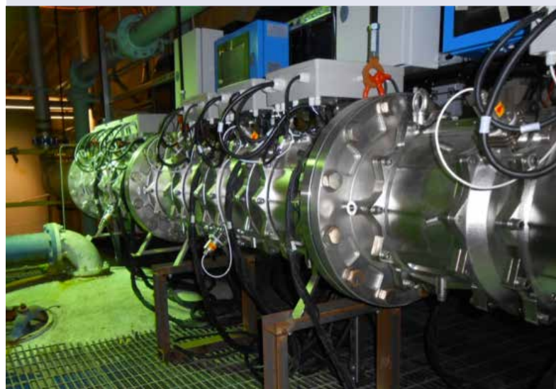
Atlantiums UV løsning installeret på Bowen kraftværket.
