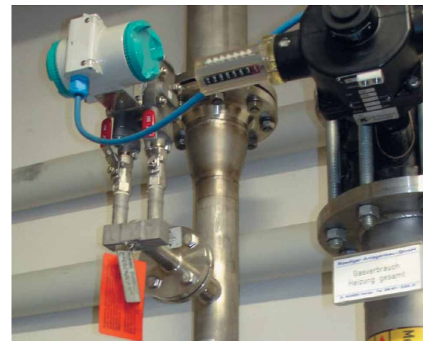
Deltaflow brugt til flowmåling af biogas.
