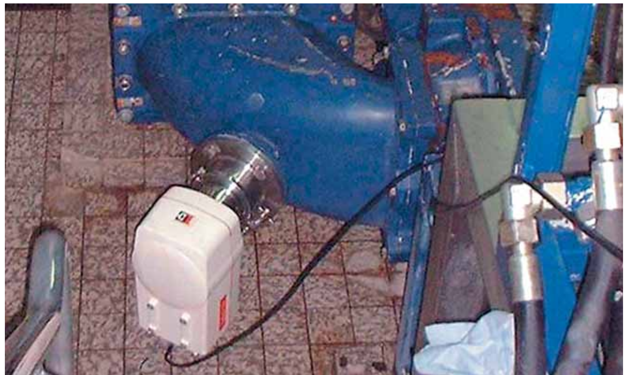
Montagen af måleren er vist på billedet: Ved at montere den i bøjningen, vil bevægelsen af slamkagen holde vinduet rent.
