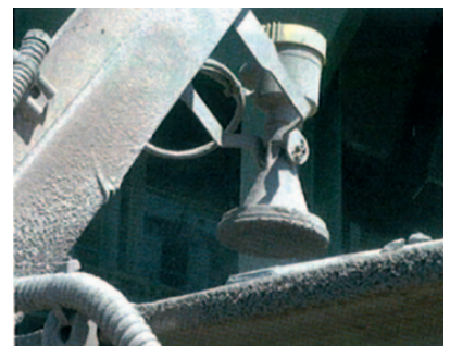
Fig. 7. Niveaumåling med radar ved påfyldning i et knuseværk i en kobbermine med radar.
