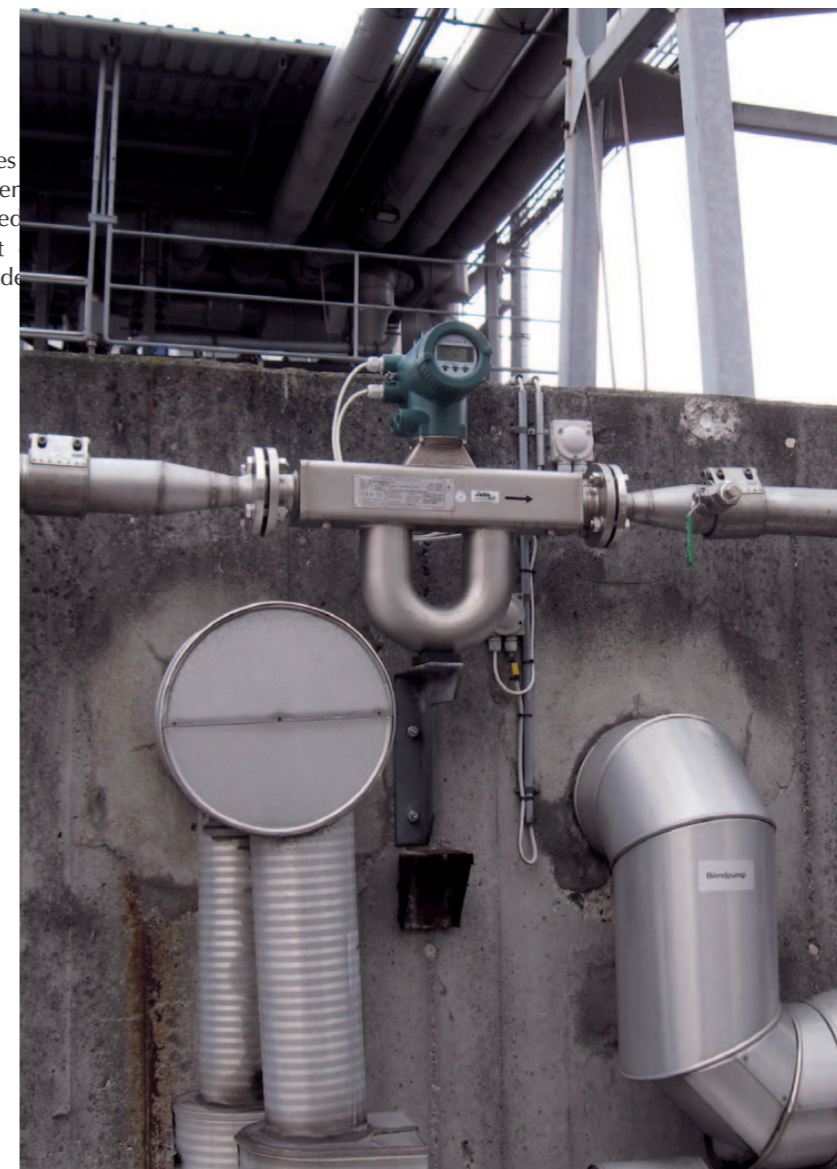
Med den nye flowmåler fra Insatech, kan doseringen af Bitumen nu foretages med en markant bedre præcision og på kortere tid.
