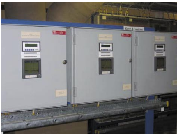
Energimåling - flowcomputere og dataopsamling
