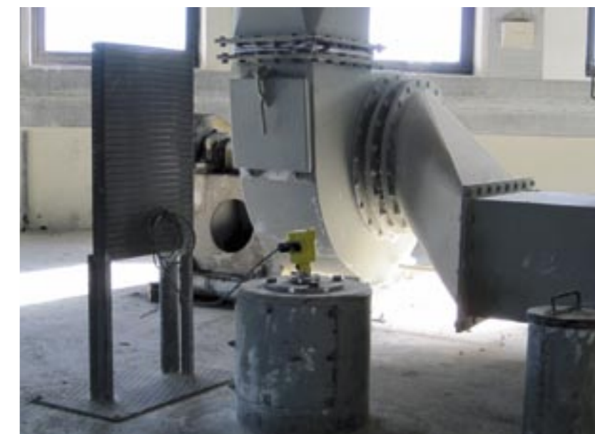
VEGA radar PULS 68 monteret på cementsilo.
