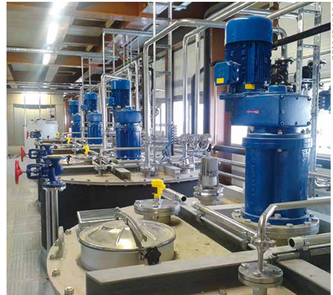
VEGAPULS 62 radarsensor måler niveauet i forberedelsestankene i silikasolproduktions-systemet. Motorene til omrørerne er klart synlige på beholderne.
