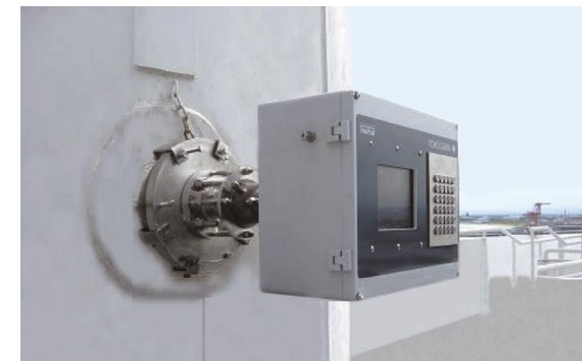
Fig. 1. TDLS200 installeret direkte på ydervæggen på skorsten. Installationspunkt A i fig. 2 på kedel uden DeNO x anlæg.
