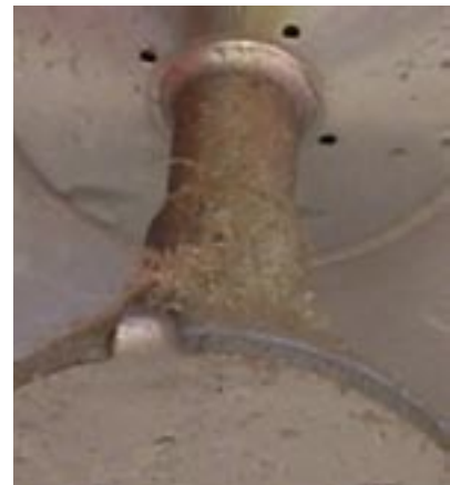
Niveaumåling på træflis. Kondensat og træflis har sat sig på antennen. I dette tilfælde var det på grund af en lukket luftventil.
