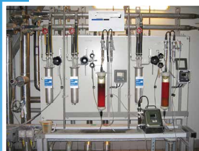
Installeret og integreret vandbar hos kunde.
