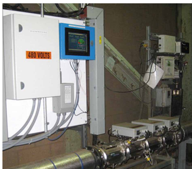
På billedet ses en UV installation hos Bailly Generating Station. I installationen her indgår rørstykket med UV lys samt display monteret på eksisterende tavle.
